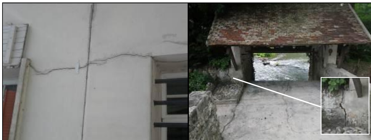
Photo 11 : Fissures sur habitation et lavoir aval du moulin de la Sault
