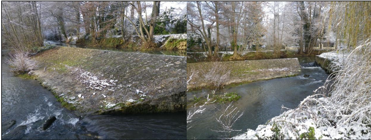
Photo 21 : Ancien déversoir du bras de décharge avec chute résiduelle importante
