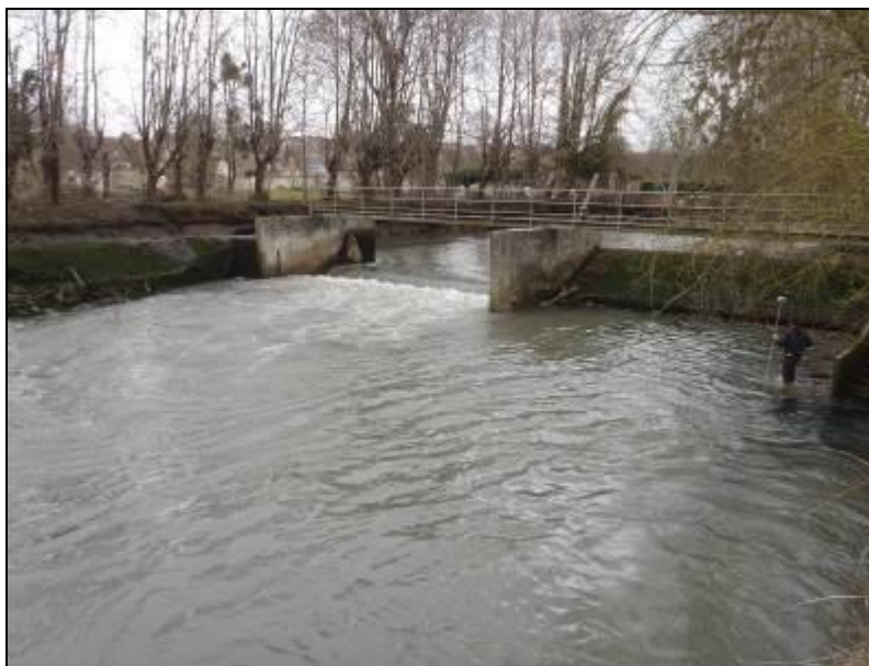
Photo 5 : Ouverture du clapet sur l'ouvrage de Mouroux
