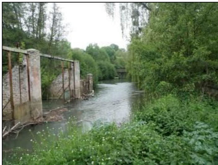
Photo 22 : Vestiges des vannages avec risque pour le passage des embarcations
